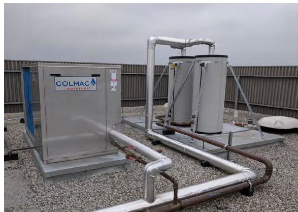
Sistema HPWH Colmac Dividido con instalación en tejado de almacenamiento de agua caliente
