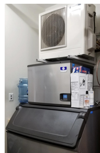
HP montado cerca del techo. (Croton 100 2020)
