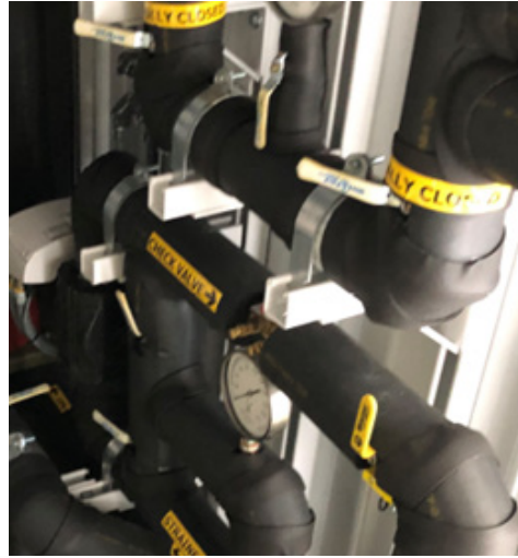
Aislamiento continuo de tuberías con soportes externos. (Ecotope 2021)
