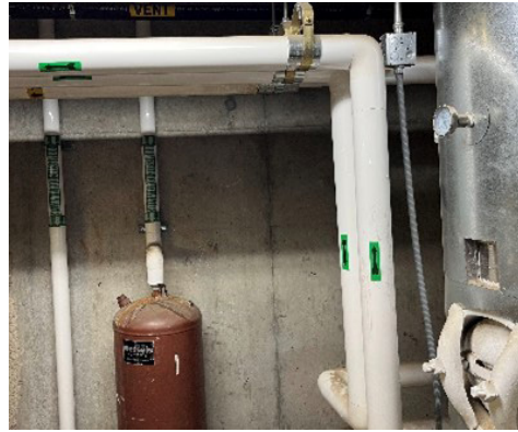
Aislamiento de tuberías de agua fría de retorno al tanque de expansión. (TRC 2023)
